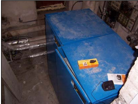
Abbildung 8: Boiler Haus Guido
